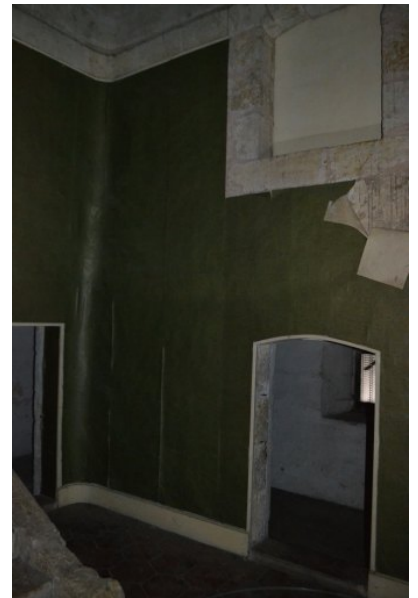
Fig. 39 - Logis, étage de soubassement, escalier d'honneur, partie située sous l'une des volées (avant travaux).
