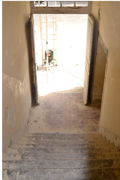
Fig. 47 - Logis, étage de soubassement, escalier donnant sur l'extérieur, vue depuis le haut (travaux en cours).
